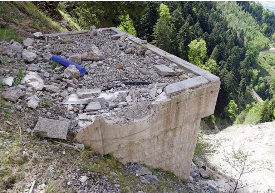
Beschädigter Quellschacht «Wissa Stä»
