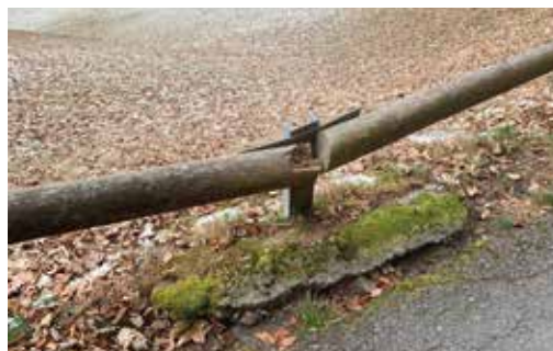
Selbst die Betonfundamente hinterlassen keinen vertrauenserweckenden Eindruck.
